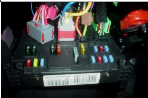
VISTA DA CAIXA DE FUSÍVEIS (CSI) DE FRENTE
